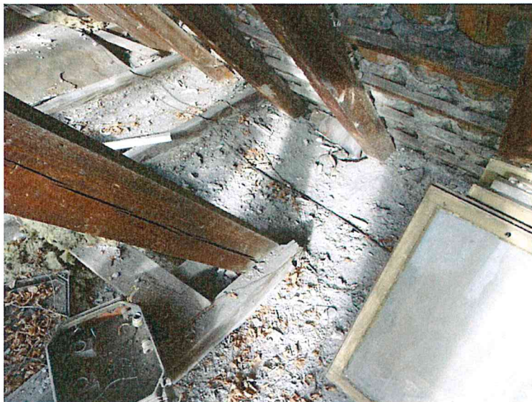
Fot.8 Fragment dachu- belki stropowe nie opierają się na murze
