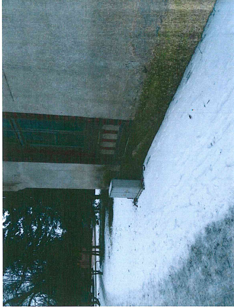
zdj. nr 7 – złącze kablowe przy budynku Starej Stolarni
